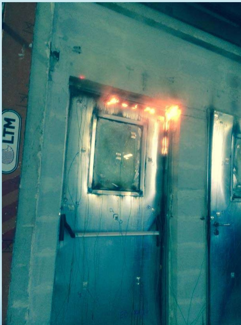
Izgled vrata nakon probijanja plamena na brtvi dovratnika
